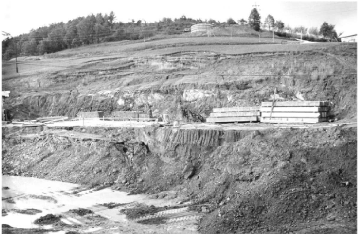
Терен који је морао да се санира (на врху резервоар Церовића брдо у изградњи)
