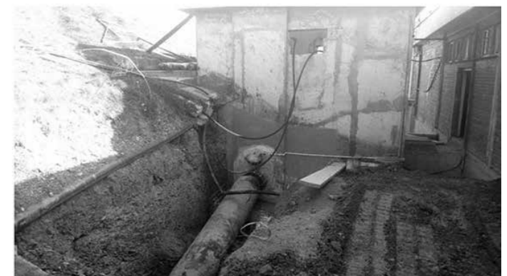
Довод сирове воде у објект расподелна комора који је поред свих осталих објекта у завршној фази реконструкције
